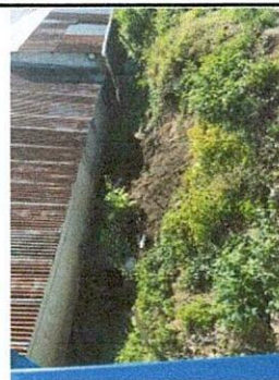
Foto 2: MEJORAMIENTO DE MURO EN VOLADIZO - Hay derrumbes que estan avanzando a lo largo de tramo de la cada y haciendo el paso de los alumnos cada vez mas pequeño e inseguro
