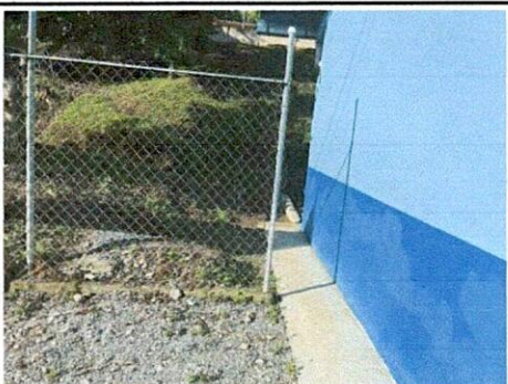
Foto 3: MEJORAMIENTO DE CERRAMIENTO - no hay buen cerramiento en la parte frontal lo que hace que sea inseguro con personas desconocidas
